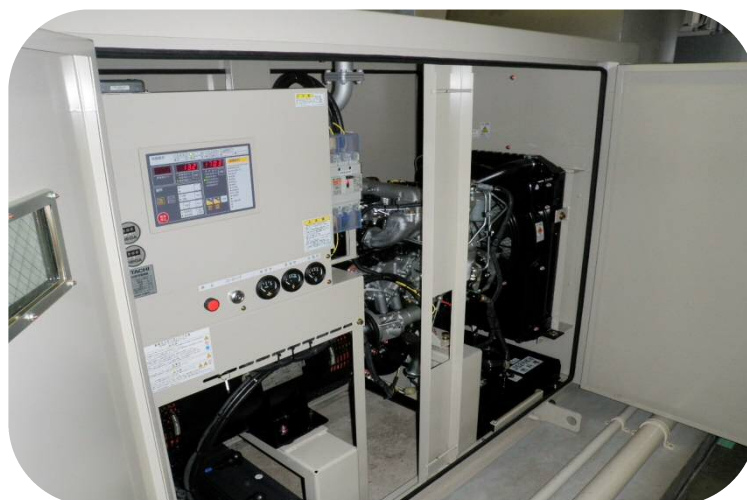
《 滝沢浄水場非常用発電機 》
