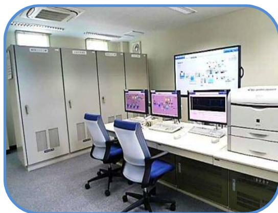
《 市内各所にある水道施設を集中的に監視する滝沢浄水場の集中監視装置 》
