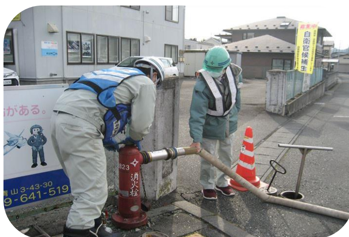
災害時に盛岡市と水道水を融通しあう連絡管の点検・整備や訓練を合同で行っています
