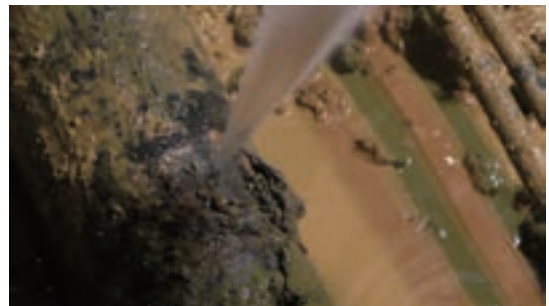
写真①管から水が吹き出る様子
