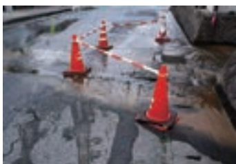
写真②漏水箇所
