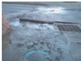
写真③漏水により舗装が盛り上がった様子
