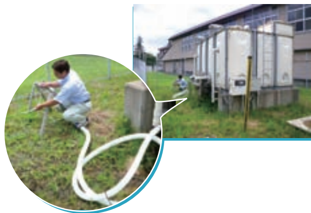
篠木小学校の受水槽は緊急時の給水拠点として利用可能
