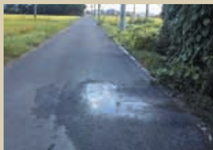
漏水によりできた水たまり
