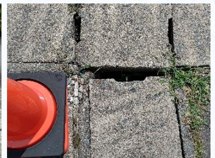
改修要請箇所2
