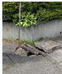
改修要請箇所1
