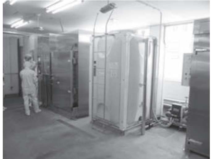
↑今回入れ替えた蒸煮冷却機（左：本体、右：給水タンク）
