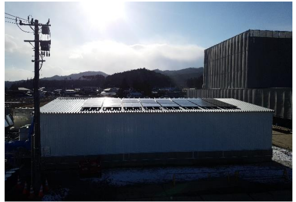
機械設備別棟上部に設置された太陽光パネルの様子
