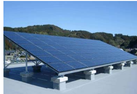
太陽光発電パネル設置例
