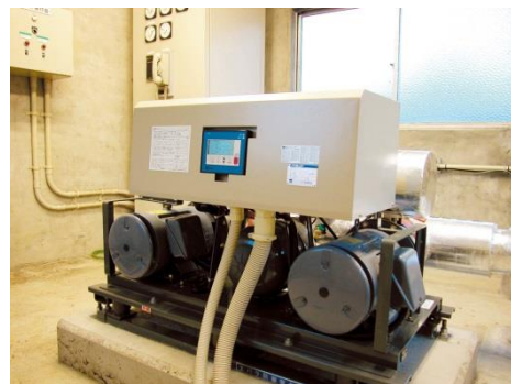
(緊急用送水ポンプ)
