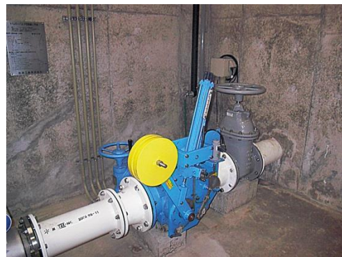
(小岩井第 2 緊急遮断弁)
